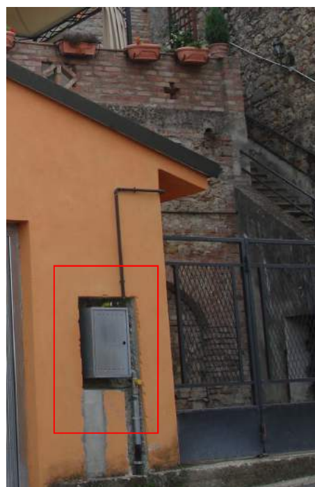
Tratti di tubazione di adduzione delle utenze installate a vista sulla facciata
